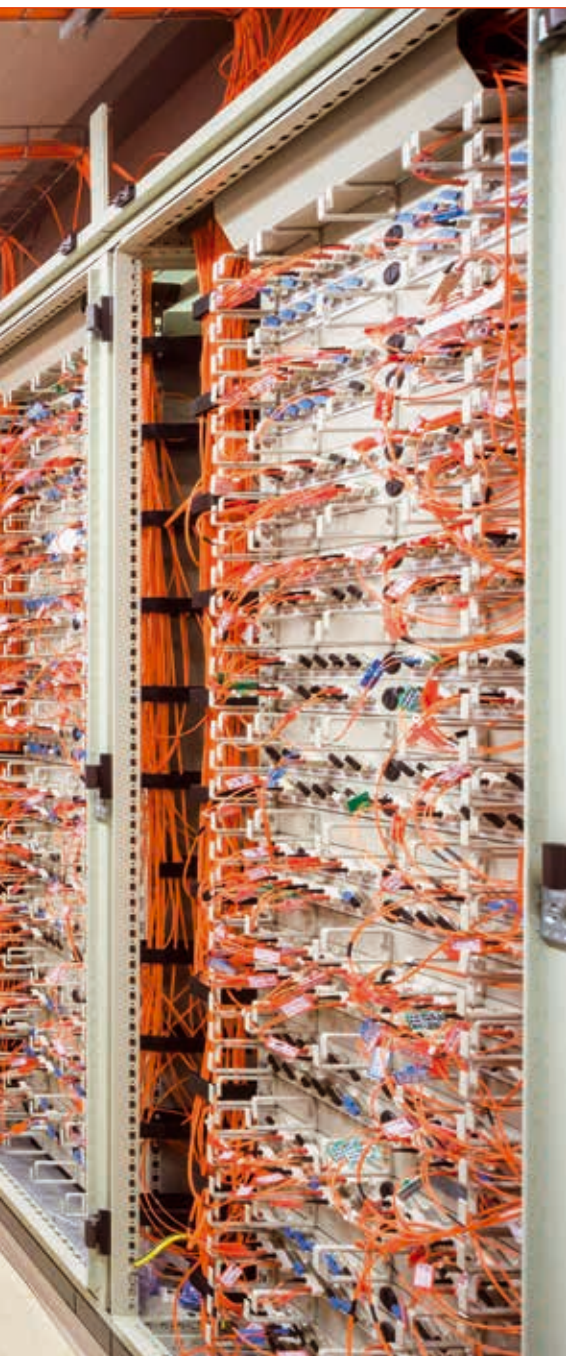
Serverräume in der Bayerischen Staatsbibliothek
